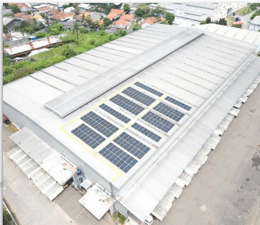
ALFAMART DC TANGERANG : 95 kWp
